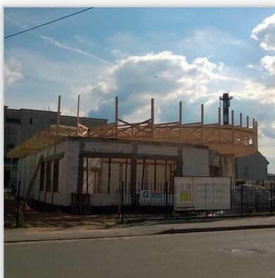
Wiązary dachowe na budynku handlowo-usługowym Powierzchnia dachu: ponad 3000 m 2 . Wysokość dachu: 9 m.
